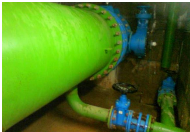
Figura 4.6 - Conduto com válvula de borboleta e bypass com válvula de cunha
