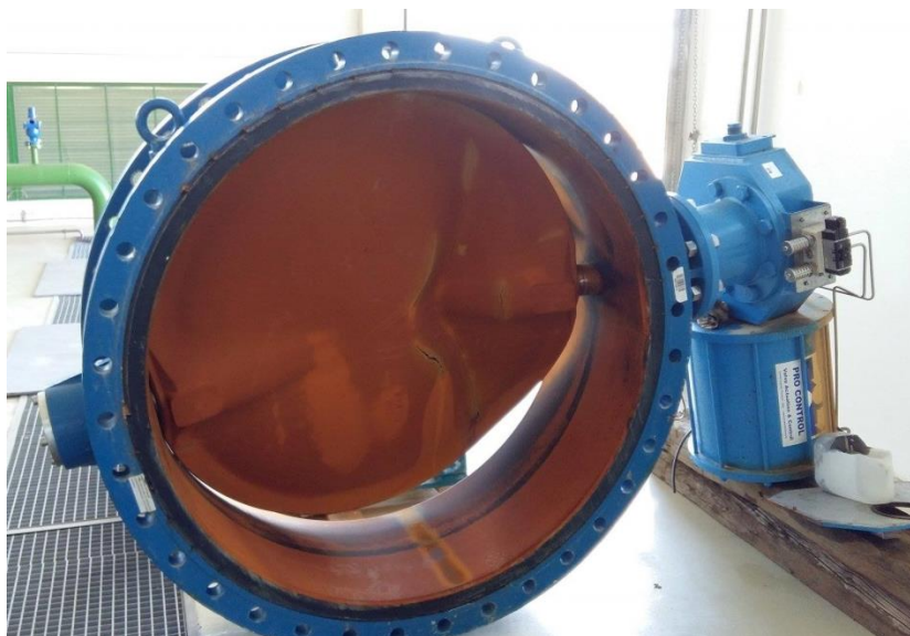
Figura 7.4 -Válvula DN1400 destruída após falha no acionamento
