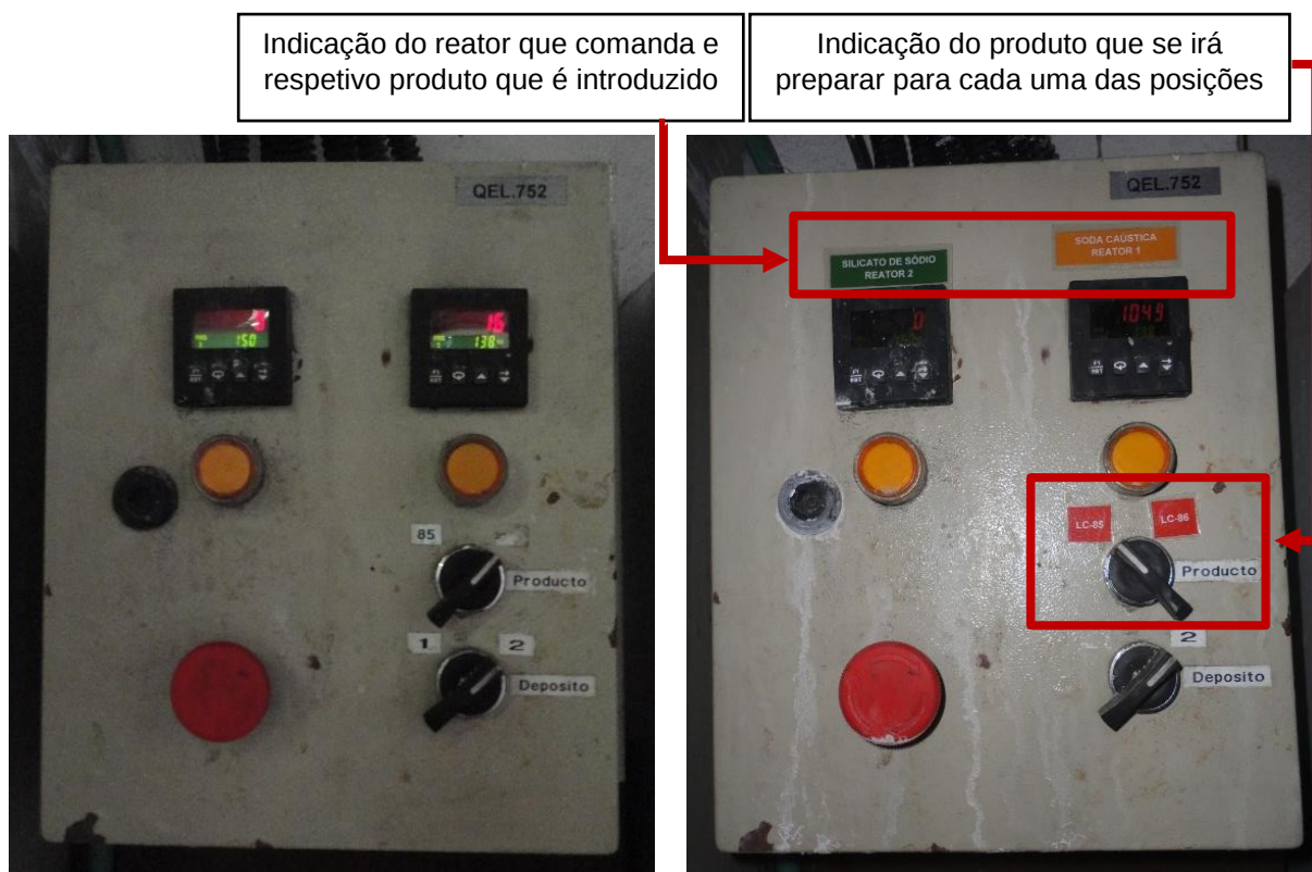
Figura 6.2 - Painel de comando Reator 1 e Reator 2 (antes)
