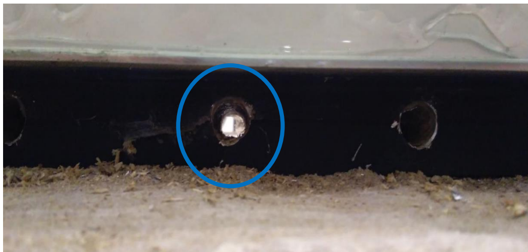
Figura 5.5 - Furos na parte inferior do perfil metálico da divisória
