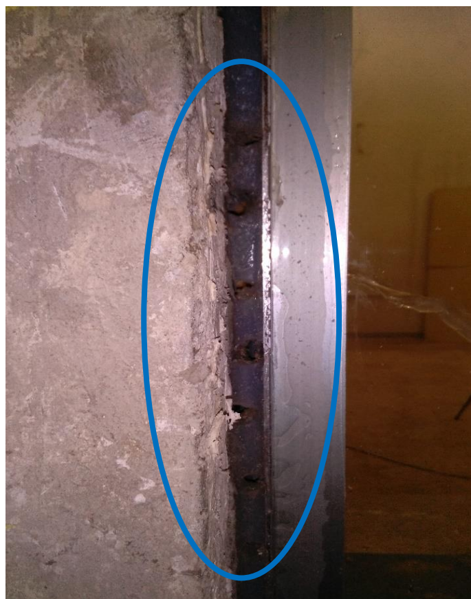
Figura 5.6 - Furos na parte lateral do perfil metálico da divisória
