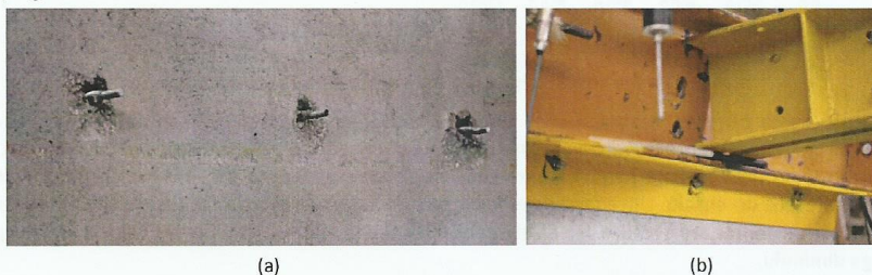
(a) – “mecanismo de ferrolho” nas pregagens; (b) – deformação dos troços de anilha em cunha soldados à cantoneira
