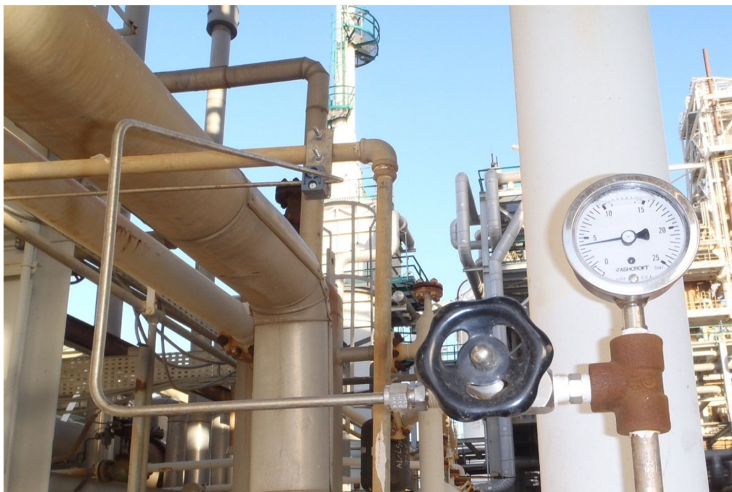
Figura 67 – Ponto de descarga da corrente de by pass do analisador de humidade
