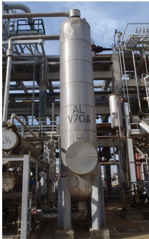
Figura 18 – Secador A de propileno da refinaria de Sines
