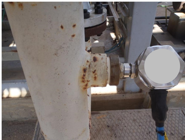
Figura 64 – Instalação do analisador de humidade directamente na linha
