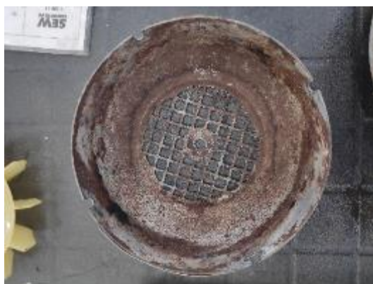
Figura 7.29 - Corrosão na proteção do ventilador do MT13
