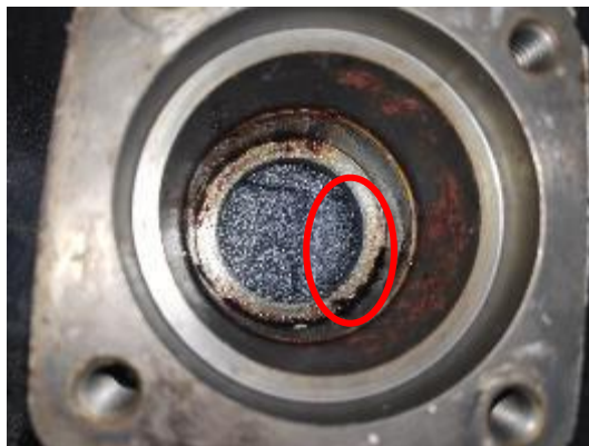
Figura 7.44 - Dano na caixa da chumaceira de rolamento do MT96
