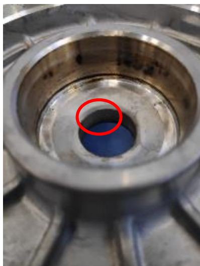
Figura 7.28 - Dano na caixa da chumaceira de rolamento do MT13
