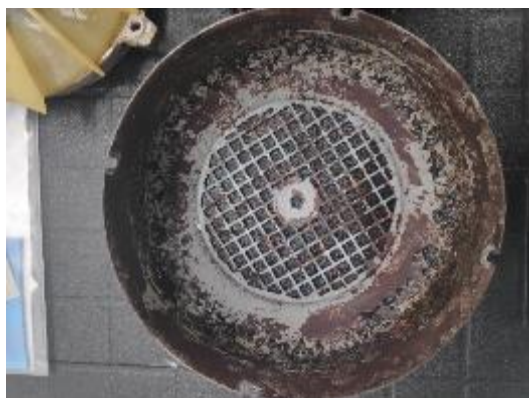
Figura 7.38 - Sujidade e corrosão na proteção do ventilador do MT79
