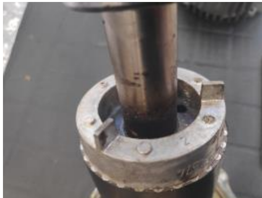
Figura 7.21 - Marca de sobreaquecimento no rotor do MT9
