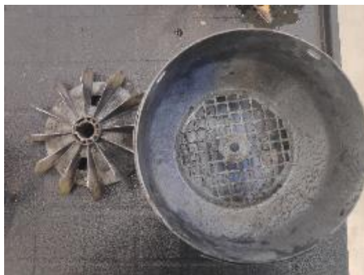
Figura 7.22 - Sujidade na proteção do ventilador do MT9
