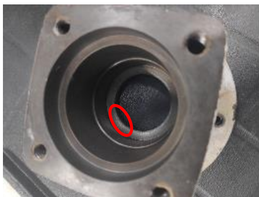
Figura 7.37 - Dano na caixa da chumaceira de rolamento do MT79
