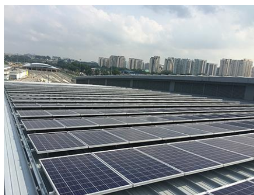
Figura 3.40- Painéis solares equipados na estação de Gali Batu, Singapura
