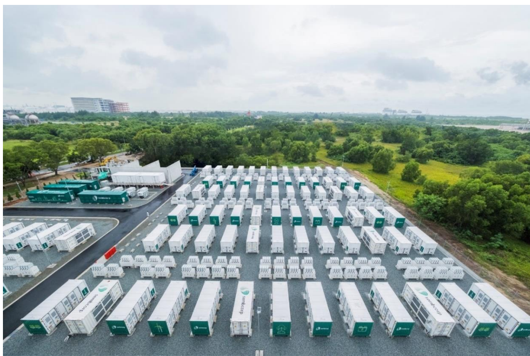
Figura 3.45- Sistema de armazenamento energético Sembcorp na ilha Jurong, Singapura (Yeo, 2022)
