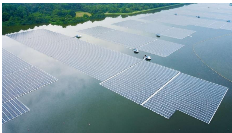
Figura 3.44- Vista aérea de sistema flutuante de painéis fotovoltaicos do reservatório de Tengeh, Singapura
