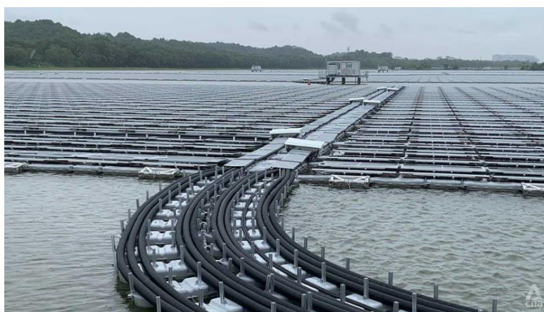
Figura 3.43- Sistema flutuante de painéis fotovoltaicos do reservatório de Tengeh, Singapura
