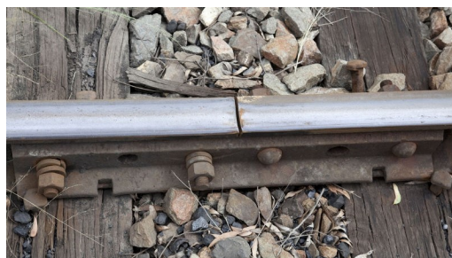
Figura 2.11: Folga existente entre secções de carris numa linha de comboios.
