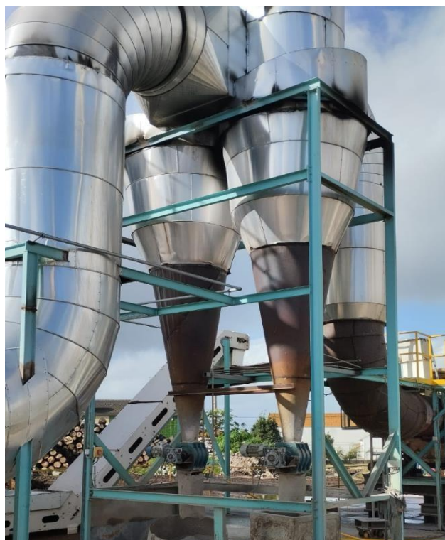
Figura 6.17: Ciclones em paralelo, montados na saída de cada secador.
