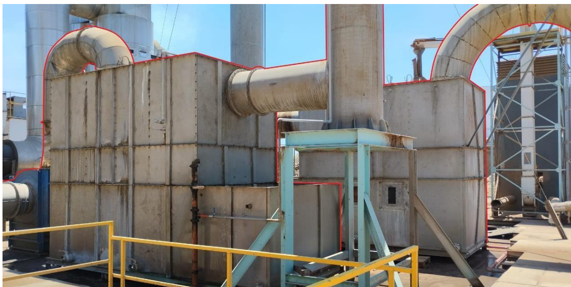
Figura 6.19: Estação de limpeza e filtragem.
