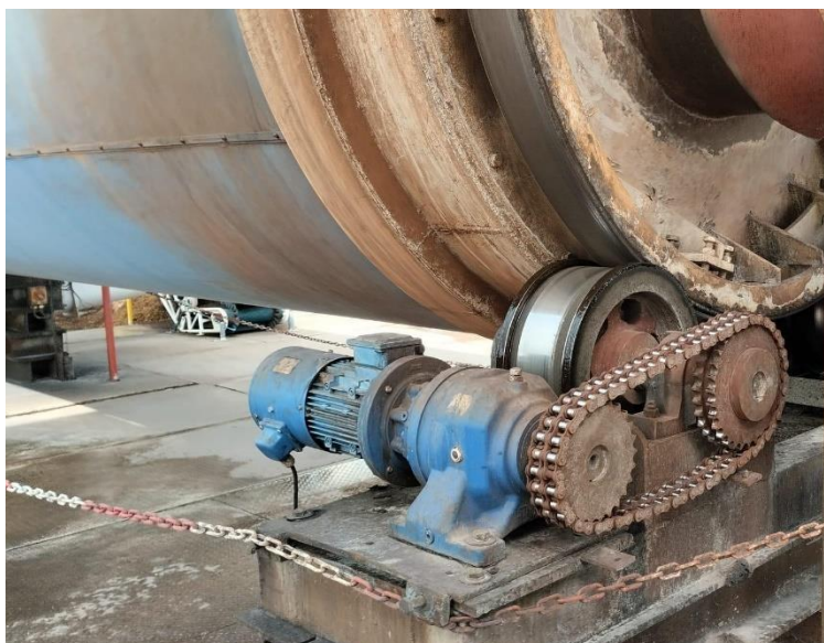
Figura 7.3: Motor de indução e elementos móveis do secador. Estes estão montados num dos flancos do secador, sob a entrada do mesmo.
