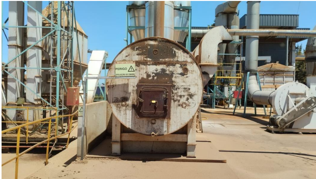
Figura 6.10: Vista frontal de uma das fornalhas na fábrica.
