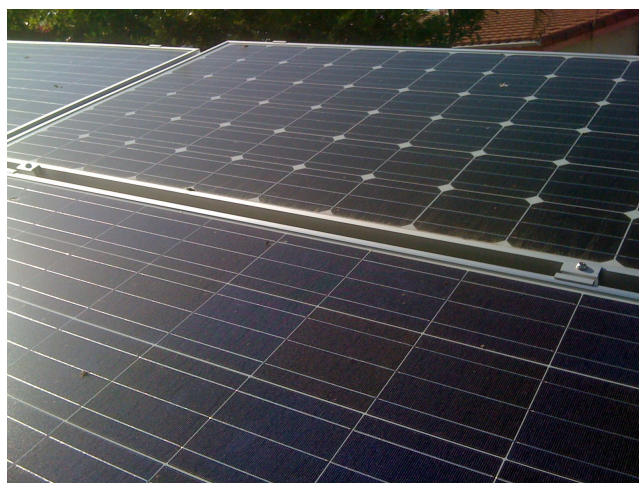
Figura 4.3: Imagem ambígua de painéis solares com poeira
