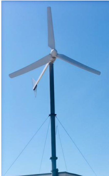
Figura 4.3 - Gerador eólico modelo FD3.6-2000L.10L (Rogado, 2018)
