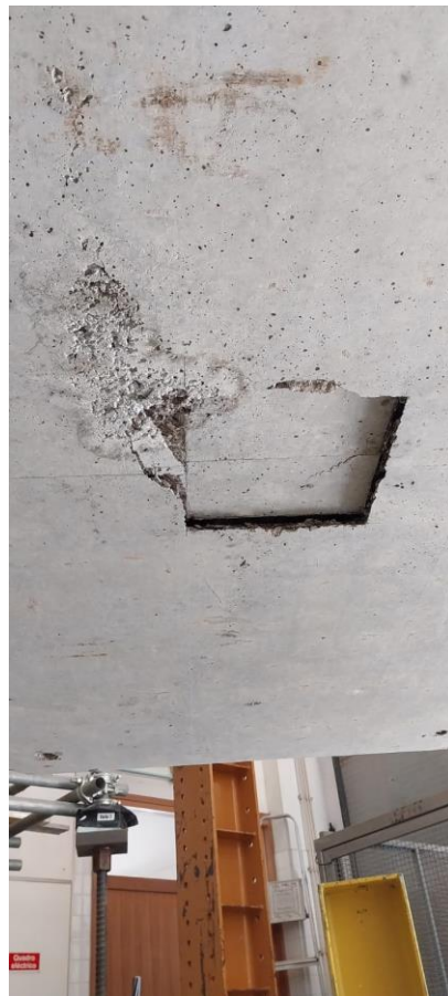
Figura 4.6 - Vista inferior da laje RCA1-50 após a rotura
