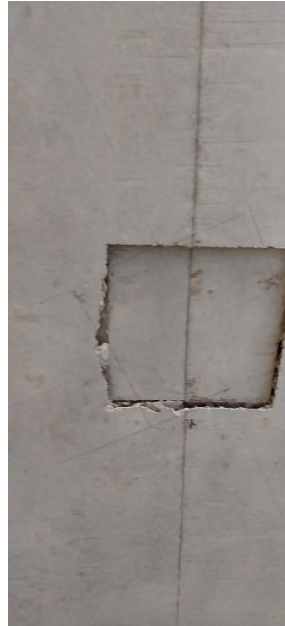
Figura 4.4 - Vista inferior da laje RCA1-0 após a rotura
