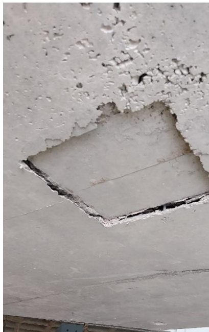
Figura 4.8 - Vista inferior da laje RCA1-100 após a rotura
