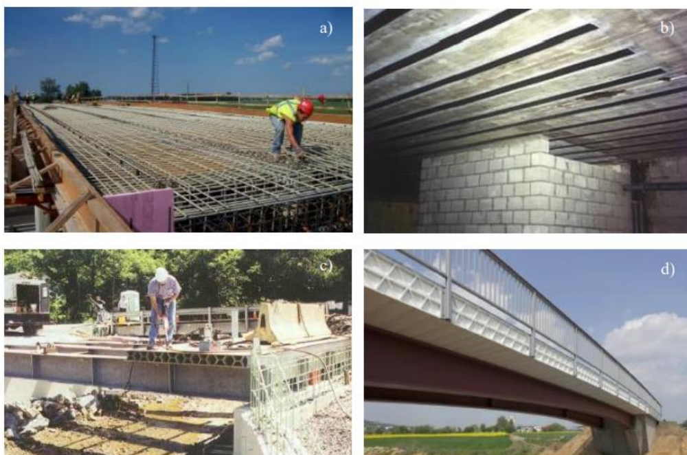
Figura 2.3: Exemplos das principais aplicações de materiais FRP: (a) armaduras interiores do tabuleiro de uma ponte; (b) reforço de uma laje maciça vigada; (c) reabilitação de uma ponte através de painéis pultrudidos; (d) estrutura híbrida (Ponte de Friedberg, Alemanha) (adaptado de [1]).
