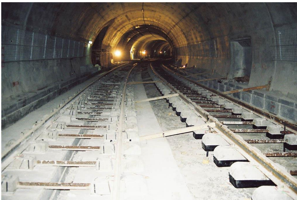
Figura 2.3 - Exemplo de travessas do ML (Construção, s.d.)
