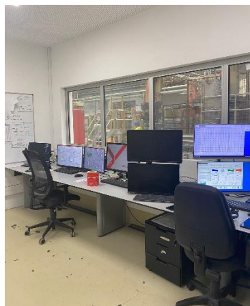
Figura 4.7 - Sala de comando da mp2
