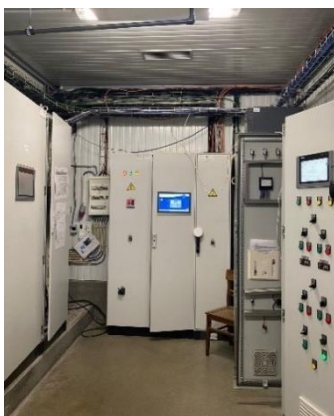
Figura 4.20 - Sala de controlo da ETAR
