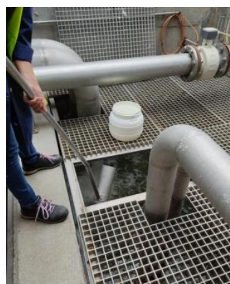
Figura 4.19 - Ponto de recolha de amostra no tanque de efluente final tratado
