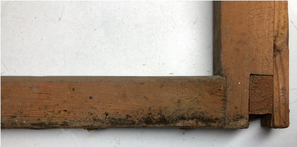
Figura 3.26: Depósitos de sujidade na grade, anteriormente tapados pela tela, e visíveis após o desengradamento.
