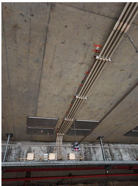
Figura 5.12: Cenário 2 - Instalação do grupo de PCM com mudança de fase a 12 °C
