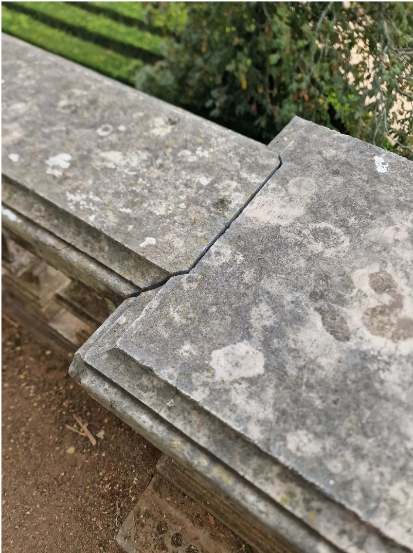
Figura 12 - Fotografia própria da balastrada com uma parte descolada no Jardim Botânico da Ajuda.
