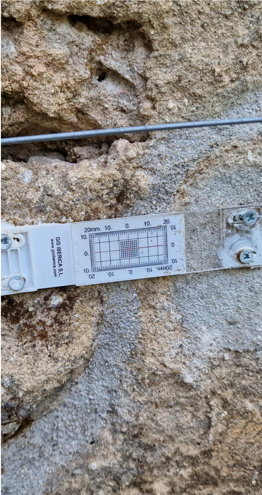
Figura 15 - Fotografia própria do fissurômetro que se encontra junto ao muro de suporte da balaustrada (entrada da Calçada do Galvão) do Jardim Botânico da Ajuda.
