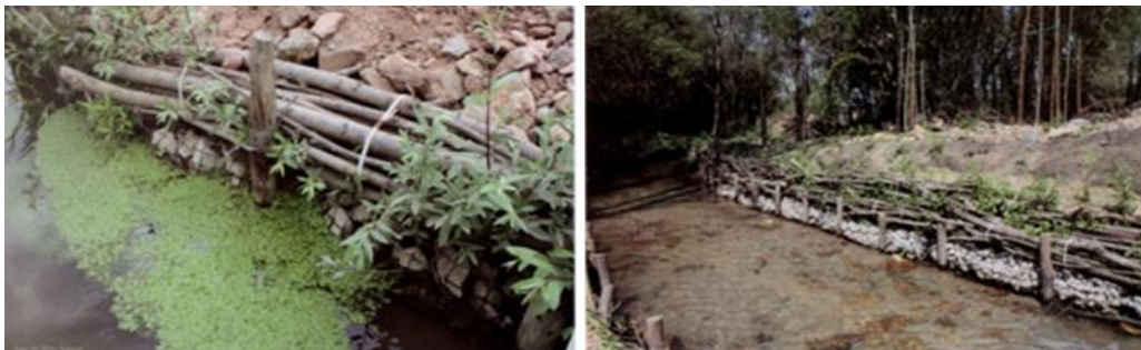
Figura 3.8 - Faxinas vivas como reforço de taludes de margem de ribeira. (Ecosalix, s.d.)
