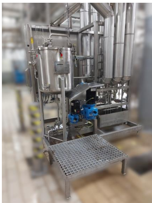
Figura 7.24 Equipamento de doseamento de extrato de malte para correção de cor da cerveja filtrada instalado na SCC.
