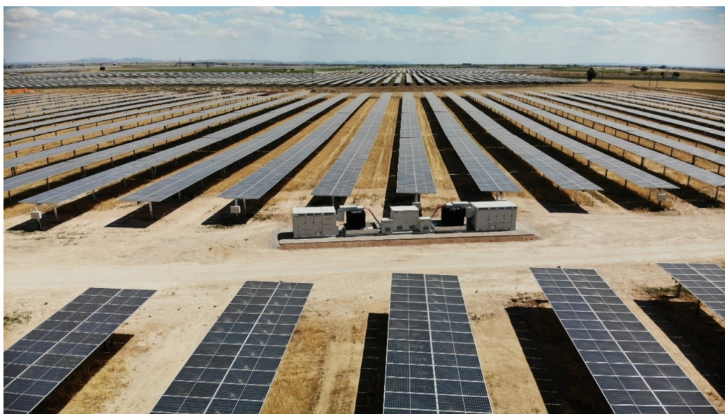
Figura 4.3: Transformador e Inversor de “Alcazar”.
