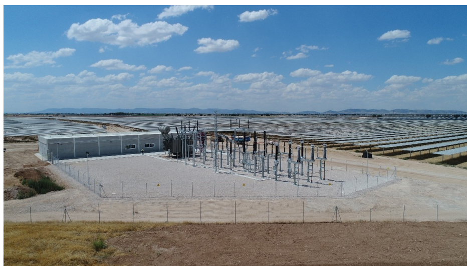
Figura 4.4: Subestação de "Alcazar".
