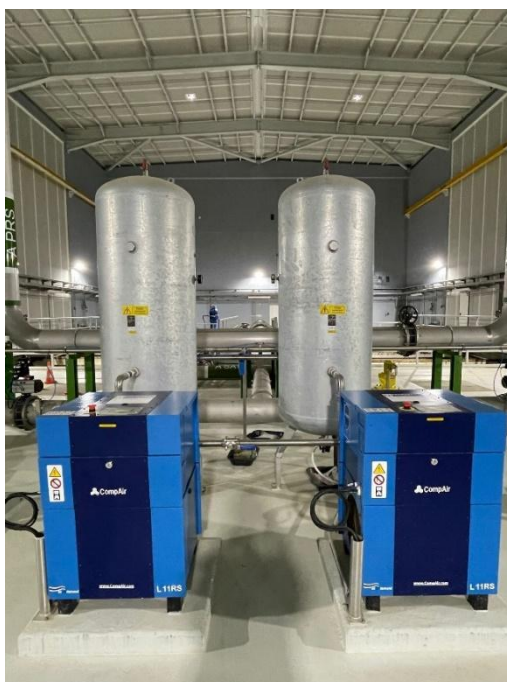
Figura 3-8. Unidades de alimentação de ar dos saturadores
