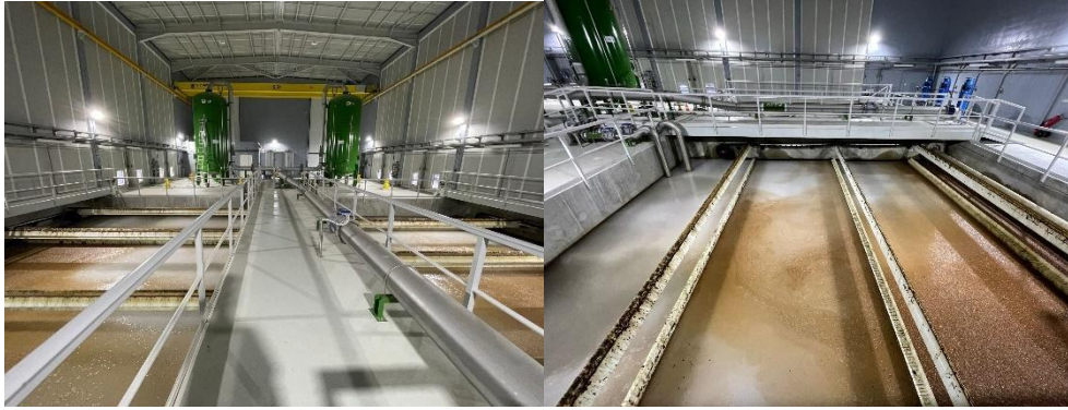
Figura 3-4. Câmaras de Flotação da ETA de Alcantarilha
