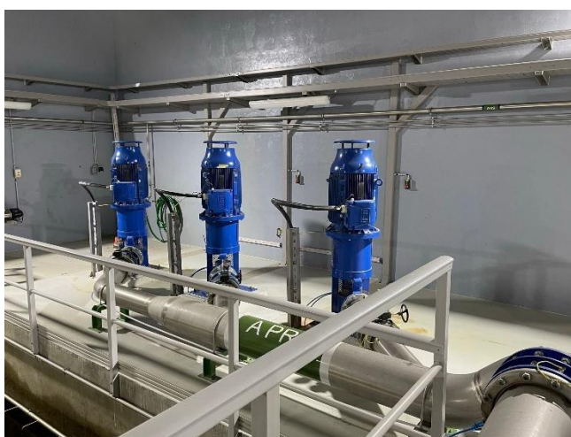
Figura 3-6. Grupos Eletrobomba responsáveis pela recirculação de água no flotador
