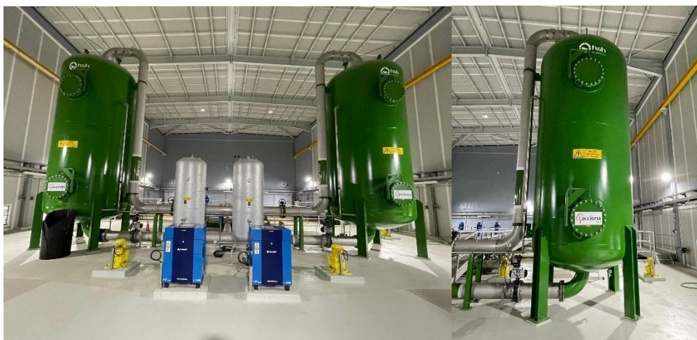
Figura 3-7. Sistema de saturação (à esquerda) e imagem aproximada de um dos saturadores (à direita)
