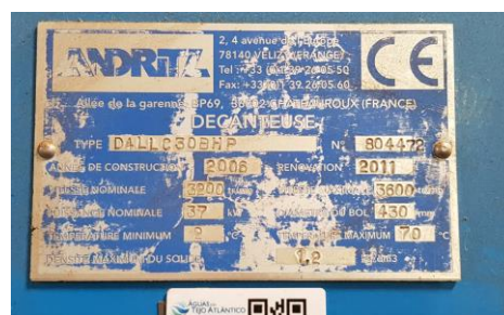
Figura 3.3 – Pormenor da chapa técnica das centrífugas da ETAR de Beirolas.
