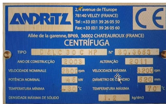
Figura 3.9 - Chapa técnica das centrífugas da ETAR de Frielas.
