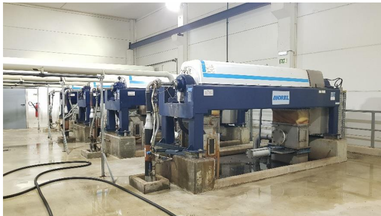
Figura 3.11 - Centrífugas da ETAR da Guia (D5LL).
