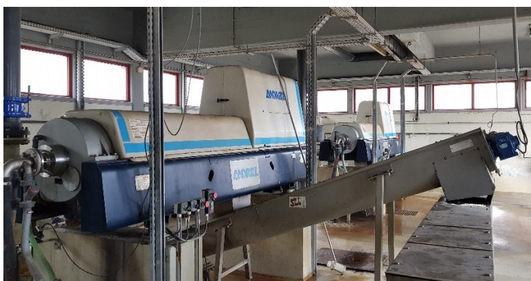
Figura 3.14 - Centrífugas da ETAR de São João da Talha (D4L).
