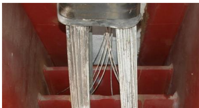
Figura 3.36 - Exemplo de fios partidos junto à ancoragem dos tirantes no tabuleiro - 2/2
