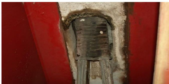
Figura 3.48 - Exemplo de infiltração de água na ancoragem do tirante no tabuleiro
