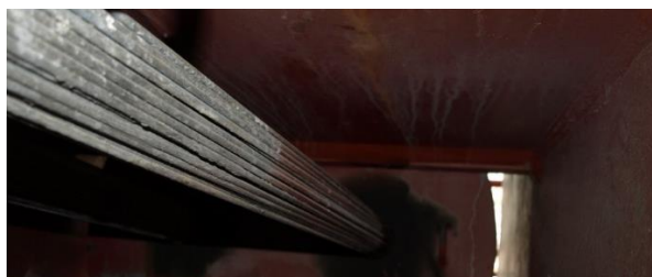
Figura 3.37 - Exemplo de fios sem tensão junto à ancoragem dos tirantes no tabuleiro
