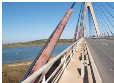
Figura 4.34 - Ponte Internacional do Guadiana. Vista geral do tubo antivandalismo no trecho inferior dos tirantes
