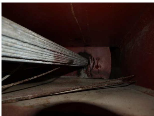
Figura 4.11 - Ponte Edgar Cardoso. Fios partidos em tirante e corrosão
