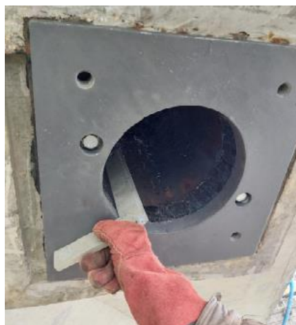
Figura 4.46 - Ponte Internacional do Gadiana. Placa metálica adicional na ancoragem no tabuleiro
