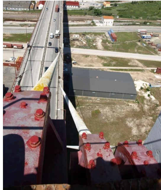
Figura 4.14 - Ponte Edgar Cardoso. Corrosão e descasque da camada de revestimento na sela de desvio de tirante, no topo da torre
