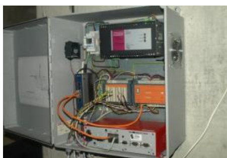
Figura 3.22 - Exemplo de caixa com computador e subsistemas de aquisição
