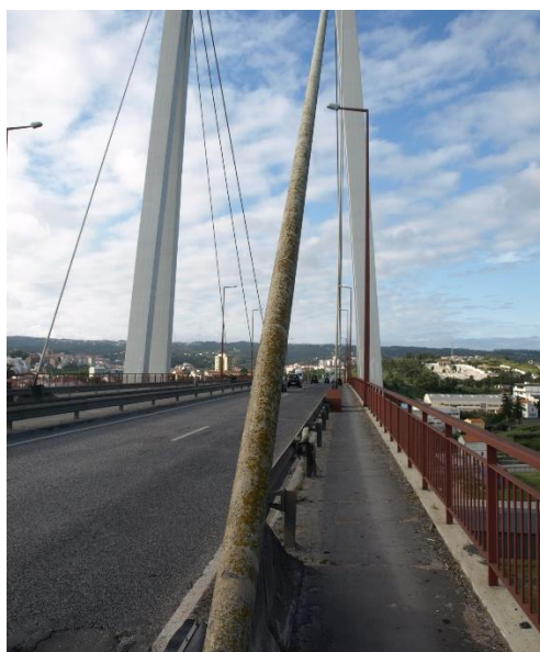
Figura 3.44 - Líquenes e fungos no revestimento do enrolamento de proteção dos tirantes
