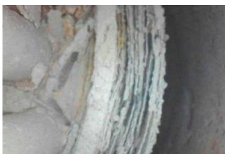
Figura 4.39 - Ponte Internacional do Guadiana. Corrosão no sistema de vedação da ancoragem
