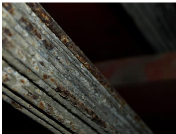
Figura 4.10 - Ponte Edgar Cardoso. Descasque da camada de proteção dos fios e corrosão
