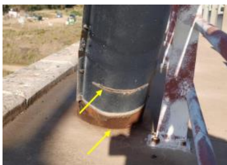
Figura 3.45 - Exemplo de um tubo antivandalismo danificado
