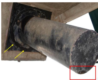
Figura 4.37 - Ponte Internacional do Guadiana. Vestígios de água e corrosão na proteção de ancoragem
