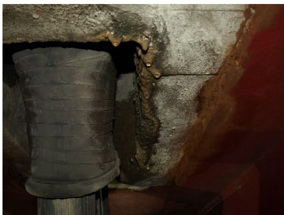
Figura 4.9 - Ponte Edgar Cardoso. Infiltração de água da chuva em ancoragem do tirante, ao nível do tabuleiro
