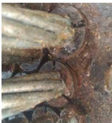
Figura 4.41 - Ponte Internacional do Guadiana. Humidade e corrosão em ancoragem no tabuleiro
