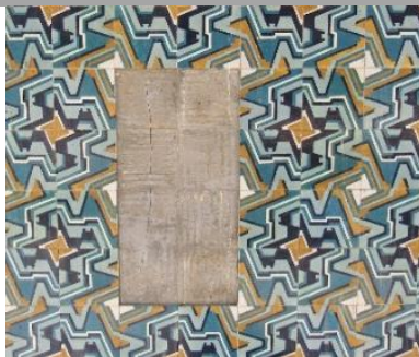
Ausência de azulejos.
