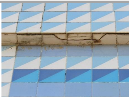
Fratura de azulejos
