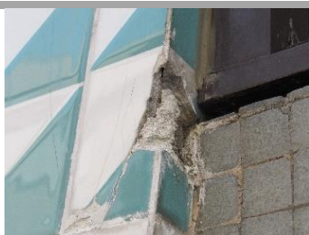
Ausência de parte dos azulejos.
