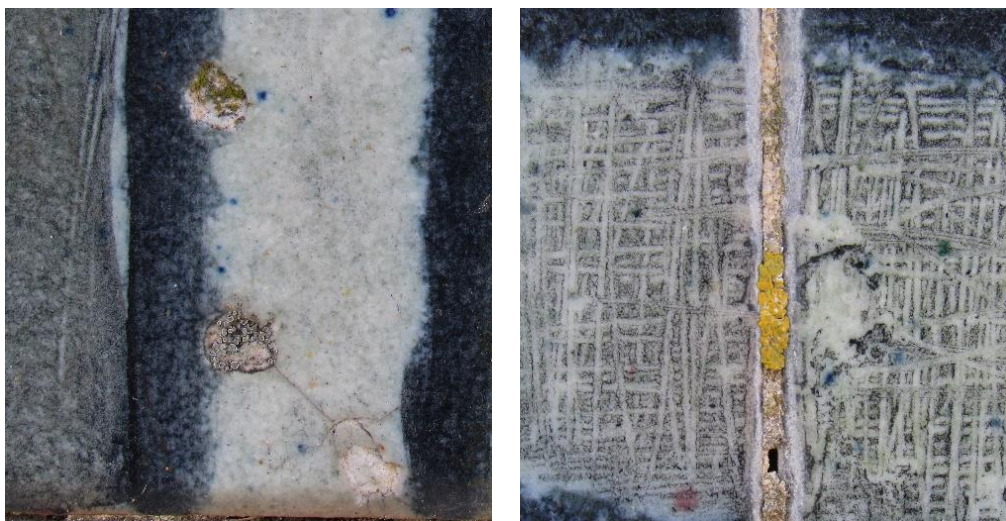
Figura 1.11 Colonização biológica nas zonas com falha de vidro e zonas das arestas
