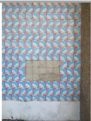
Ausência de azulejos.
