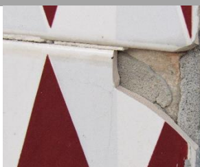
Perda de parte dos azulejos.
