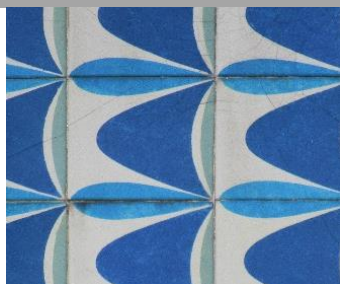
Fissuras de vidroado.
