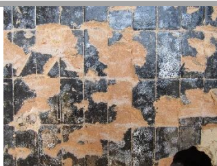
Perda de vidroado.
