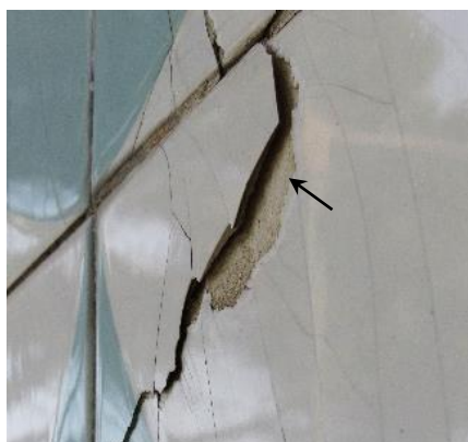
Rutura e destacamento de vidro.
