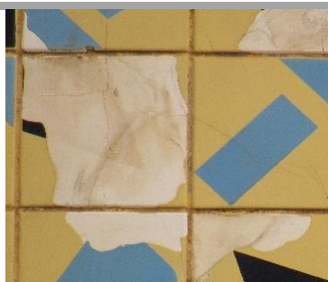
Fissura de chacota.
