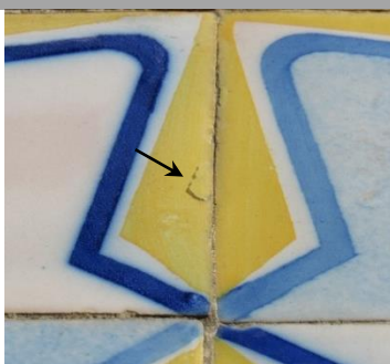
Empolamento e destacamento de vidro.
