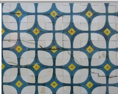
Fraturas de azulejos.
