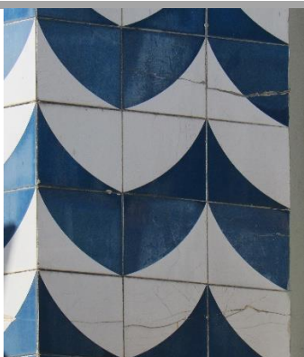
Fraturas dos azulejos.
