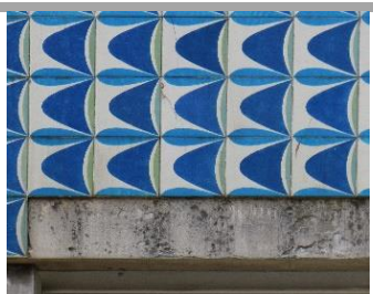
Ausência de azulejos.
