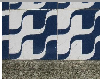
Fissuras de vidroado.
