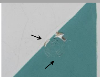
Punção que origina fissuras em raios (linhas que levam ao destacamento de vidrado)
