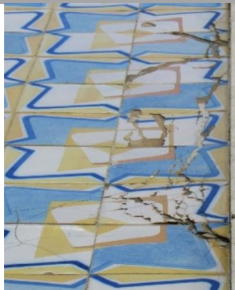
Fraturas dos azulejos.
