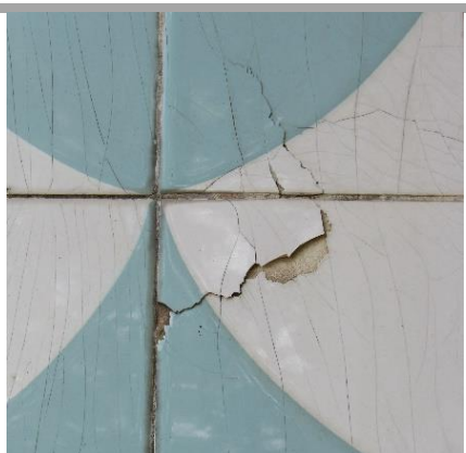
Empolamento e destacamento do vidro. Não existe um padrão para a perda de vidro, parecendo ocorrer em qualquer local de maior fragilidade e por vezes, ocorre de forma limpa (sem chacota aderente).
