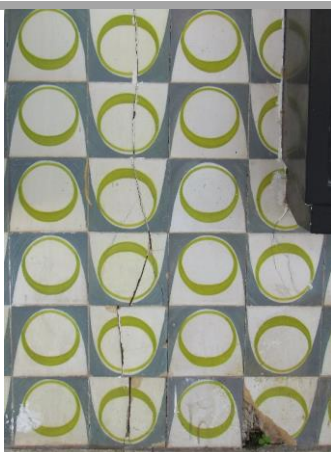
Fissuras de vidro e fraturas dos azulejos.
