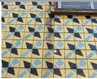
Fraturas dos azulejos
