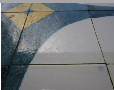
Fissuras de vidrado.
