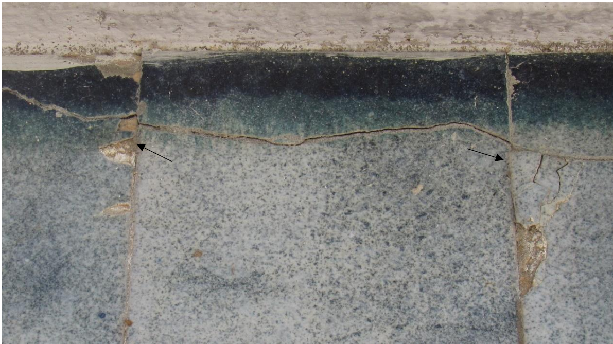
Figura 1.27 Fraturas que originam o destacamento do vidrado e posteriormente a falha de vidrado
