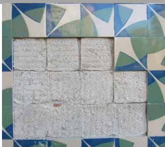
Ausência de azulejos.
