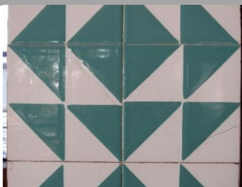
Fissuras de vidro.
