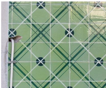
Ausência de parte dos azulejos
