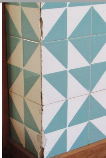
Perda de parte dos azulejos
