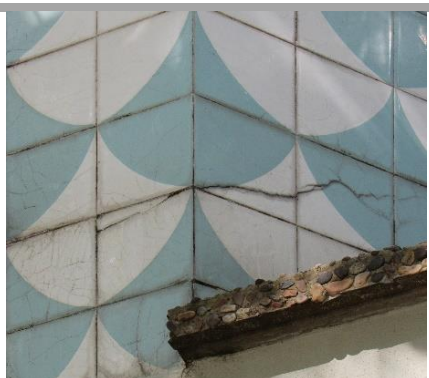
Fraturas dos azulejos.
