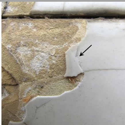
Destacamento de vidrado branco.
