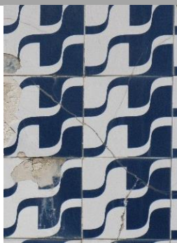
Fraturas dos azulejos.
