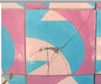
Fraturas dos azulejos.
