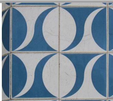
Fissuras de vidrado.
