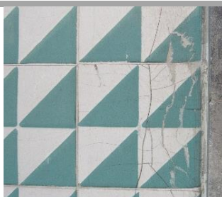
Fratuira de azulejos.
