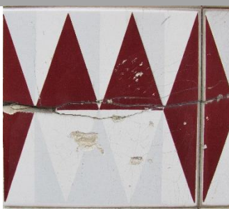
Fratura de azulejos.
