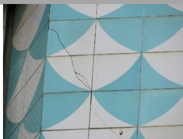
Fraturas dos azulejos.
