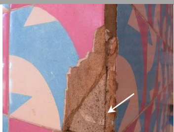
Perda de parte de azulejos
