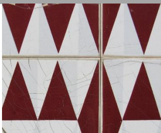
Fissuras de vidroado.
