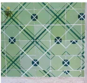
Azulejos de cor ligeiramente mais clara e interrompendo o padrão – possível intervenção
