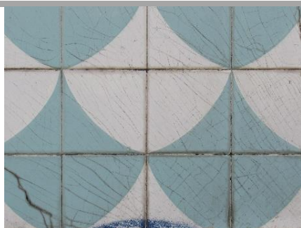
Fissuras de vidro.
