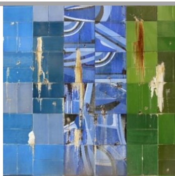
Presença de ferrugem.
