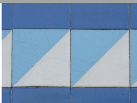
Fissuração dos azulejos.
