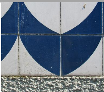
Fissuras de vidro.
