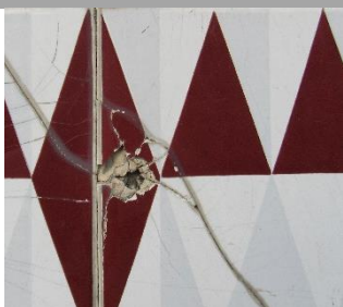
Destacamento e perda de vidroado e parte da chacota.
