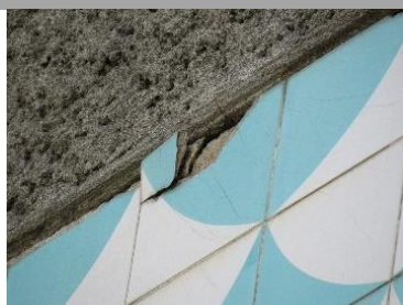
Destacamento de parte de azulejo.
