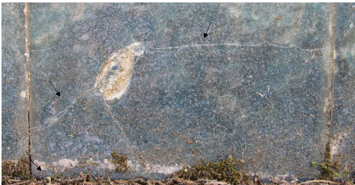
Figura 1.18 Dano por punção com fissuração da chacota e propagação de fissuras no vidro
