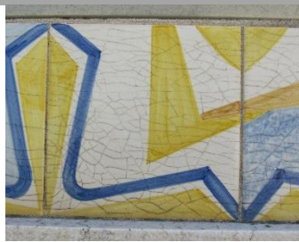
Fissuração dos azulejos.
