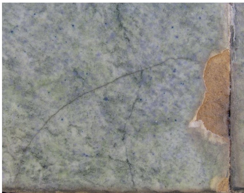
Figura 1.14 Destacamento do vidro que originou fratura do vidro
