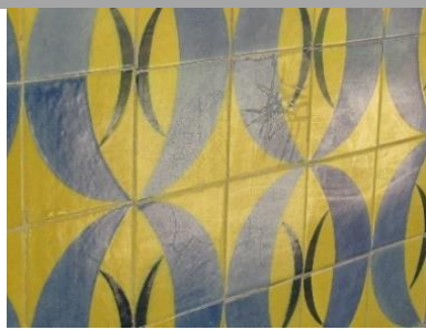
Fissuração dos azulejos.
