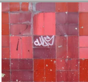
Vandalismo: picado e graffiti
