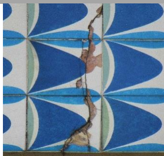
Fraturas dos azulejos.
