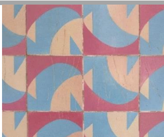
Fissuração de vidrado
