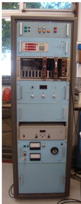
Figura 11: Rack com as unidades de controlo e operação da fonte de radiação, bobinas de Helmholtz, sistema de bombeamento e detetor.
